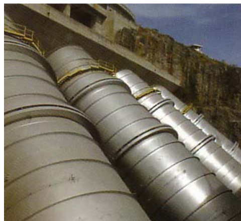
Fot. 3: Rurociągi derywacyjne z przetwornikami przepływomierzy
